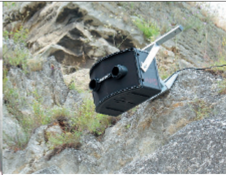
Bose-Lautsprecher des Typs 802 sind u. a. an der rückwärtigen Felswand montiert
